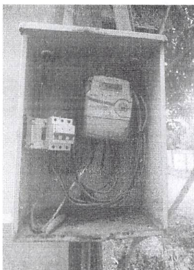
Foto 9: Quadro de Distribuição de Energia
