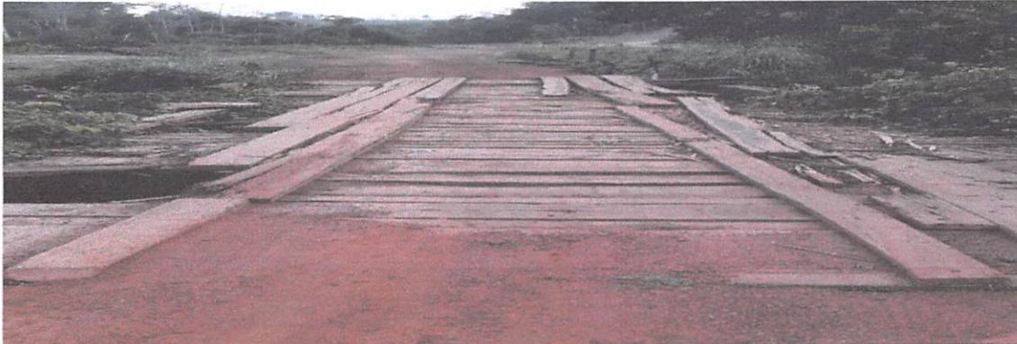
PONTE DE 17 X 5 METROS, PRÓXIMO AO BAR DO ZÉ, RAMAL DA VILA UNIÃO, ASSOALHO QUEBRADO E LONGARINAS DANIFICADAS.
