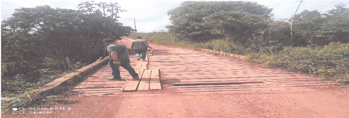
PONTE 15 X 5 METROS, PRÓXIMO AO SÍTIO DO ZÉ POMBA, RAMAL DEPOIS DA AREIA BRANCA, MADEIRA DETERIORADA, SEM DESLIZANTES.
